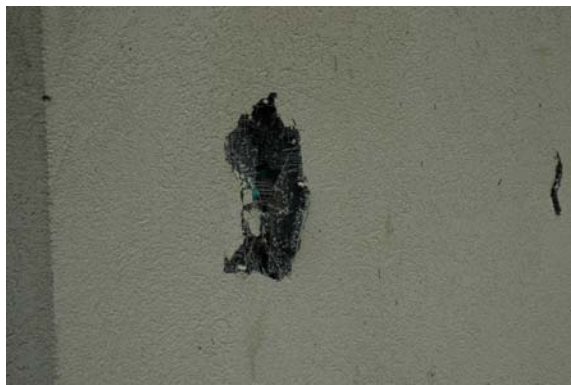
Mur percé par des projectiles emportés par la tornade.
