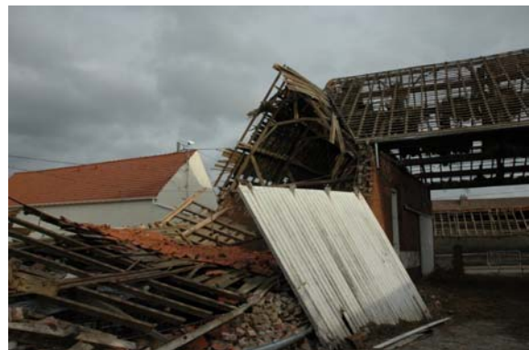
Corps de ferme éventré, malgré des murs en brique d'une épaisseur de 50 cm. Toitures fortement endommagées.
