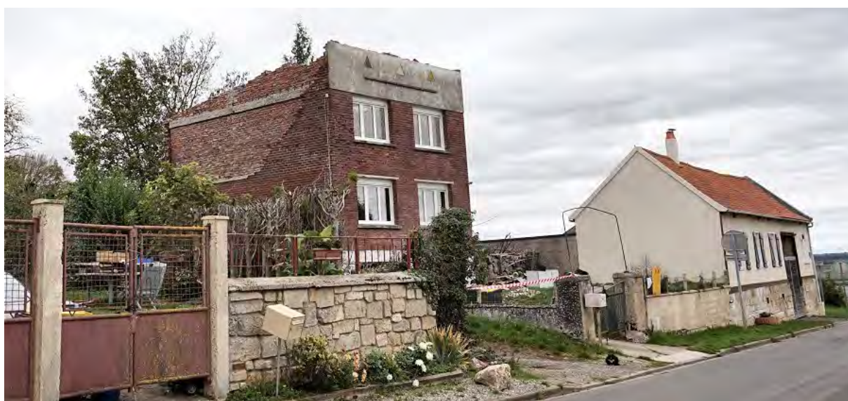
[1] Belleuse – Toiture emportée d'un bloc vers l'ENE, rue de Conty © G. Milcareck
