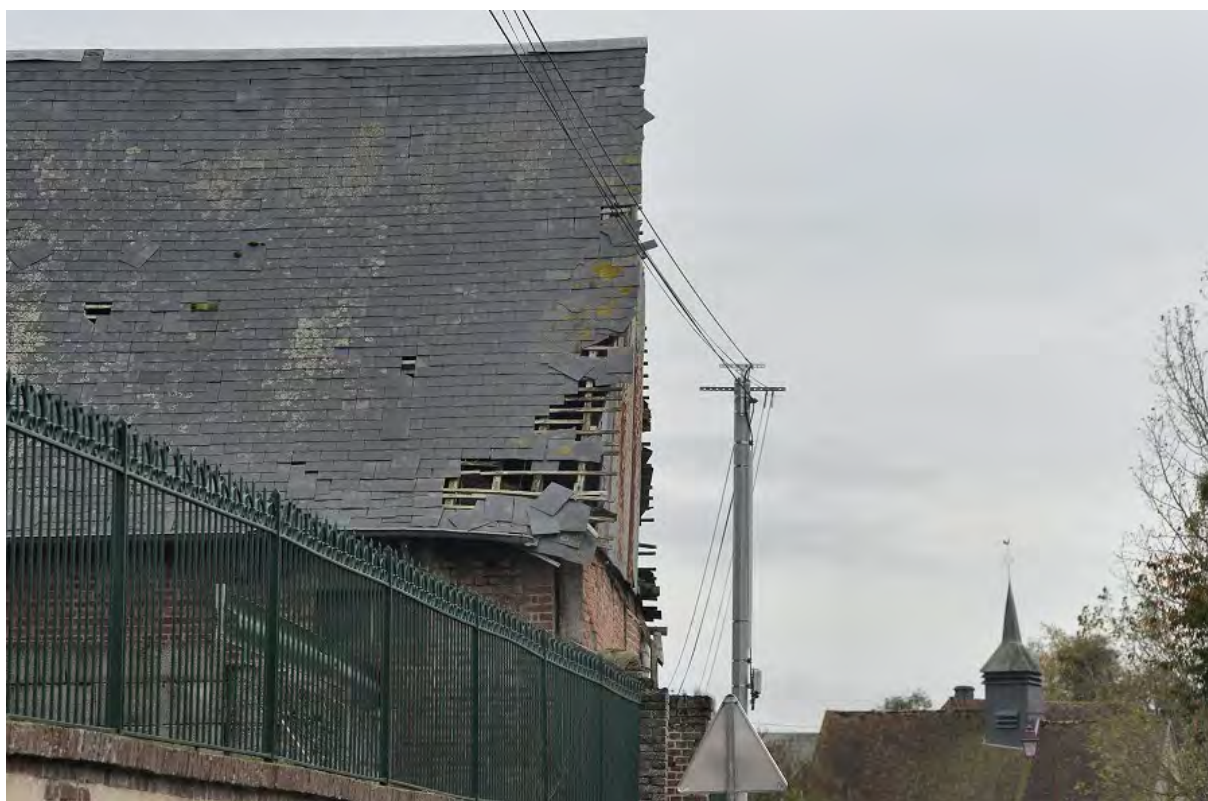
[5] Ernemont-la-Villette – Quelques tuiles emportées à l'entrée du village, en bordure nord-ouest du couloir. Elles sont principalement aspirées vers le sud ou le sud-est. © Keraunos
