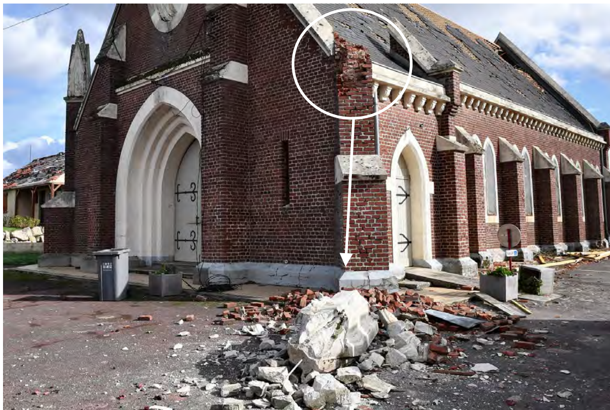
[2] Bihucourt – Chute d'un clocheton qui est venu s'écraser au sol © Keraunos
