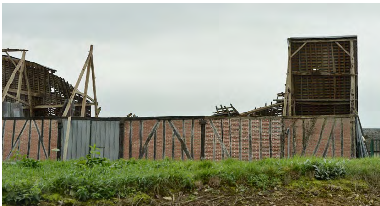
[3] Songeons – Second bâtiment de ferme éventré (façade côté rue des Champs) © Keraunos
