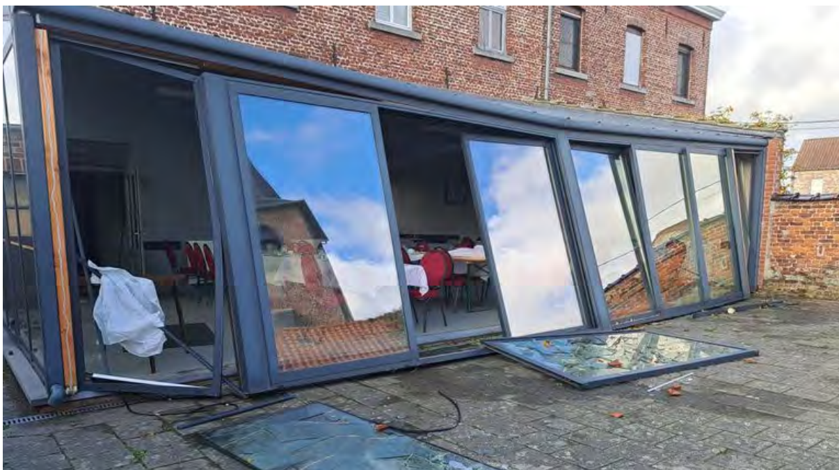
[5] Willaupuis – Ce qu’il reste de la véranda de la maison de village. La structure, exposée vers le nord-est, protégée par la maison et donc abritée du vent, est littéralement aspirée. L’église (visible dans le reflet d’une des vitres) est à peine touchée. © L’Avenir
