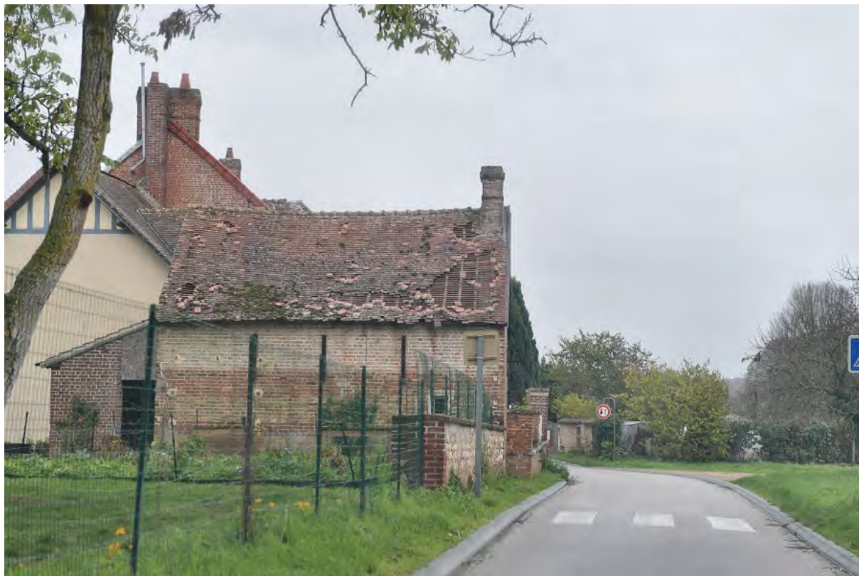
[5] Muids – Tuiles arrachées sur une toiture, rue de la Messe © Keraunos
