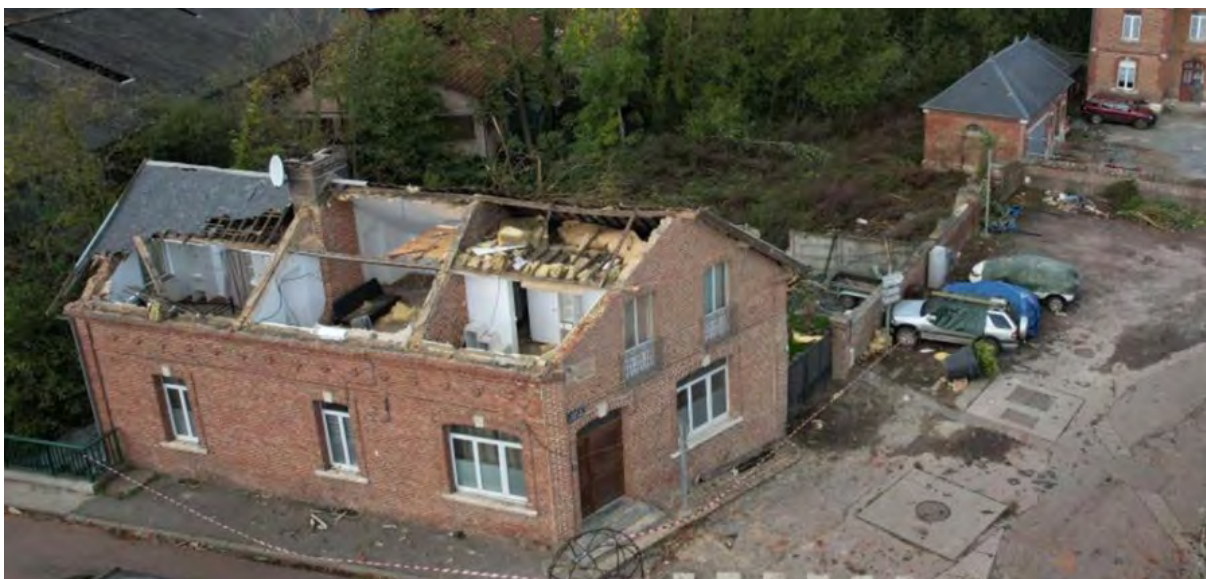
[2] Conty – Pans de toitures arrachés, rue du Général-Leclerc © Sdis 80
