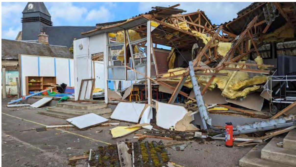
[2] Gaudechart – Ce qu'il reste de la cantine et de la salle de motricité de l'école. Derrière, l'église n'a souffert que de la perte de quelques ardoises. © Courrier Picard
